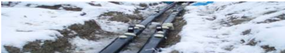
Verfahren zur Rohrerwärmung - Generell müssen die Oberflächen der Stahlrohrverbindungen und der Mantelrohringraum der Muffenverbindung über die gesamte Dämm- und Dichtphase sicher auf Temperaturen zwischen +5^{\circ}\text{C} und +45^{\circ}\text{C} gehalten werden.
